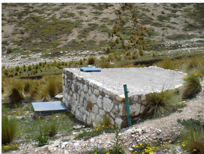
Captación Chuchimachay Nº 2
